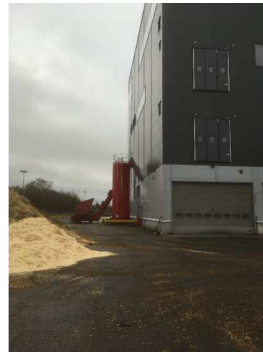
Tank i rustfritt stål 30m 3 (Vetlanda)
